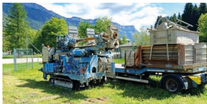
Grundwassererschließung sichert autonome Wasserversorgung für die Badeanlage. Foto: Gemeinde
