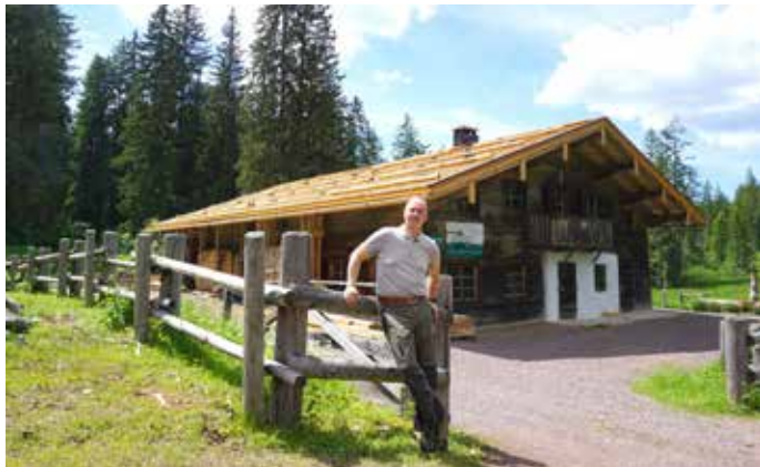
Revierleiter Stefan Spreng leitete den Neubau des Daches im historischen Stil mit Schindeldeckung. Foto: Thomas Zanker
