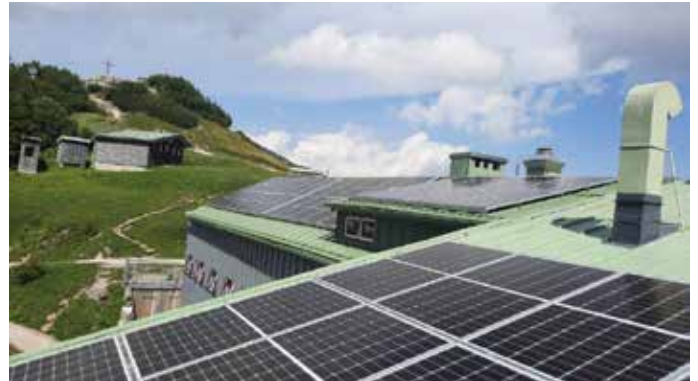
Eine große Dachfläche wurde mit Photovoltaik-Elementen bestückt
